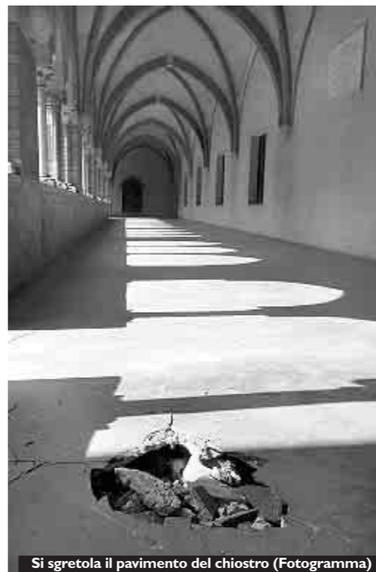
Si sgretola il pavimento del chiostro (Fotogramma)
