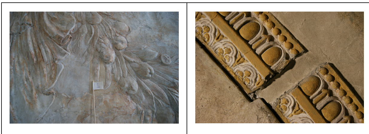
Particolari dello stato di conservazione
